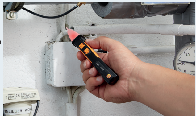
Bezkontaktné meranie napätia v rozvodnej skrini vykurovacieho systému s testo 745.
