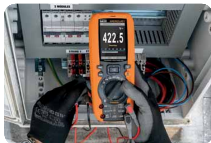
FV string Vmpp měření
