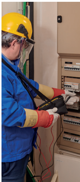
Měření na rozváděči
